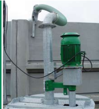
Överpumpning från pumpbrunn till lagringsbrunn
